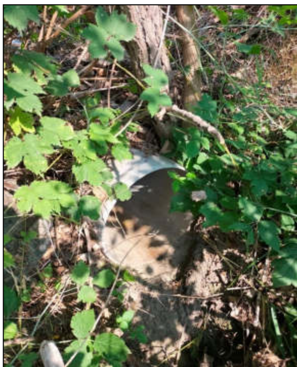
Figura sopra: Tubazione di scarico in Dora Baltea
